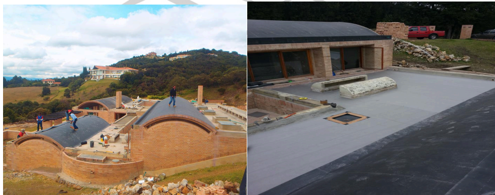
IMPERMEABILIZACION CON MEMBRANAS EPDM DE FIRESTONE EN CUBIERTAS CASA LA CATALANA ARQUITECTO ROGELIO SALMONA SINDAMANOY CHIA
