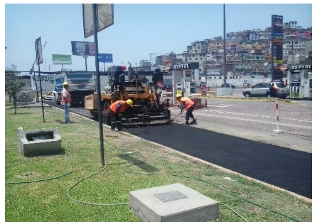
Asfaltado VIA DE EVITAMIENTO Grifo Repsol) - Frente Cerro San Cristóbal - Rímac, Sep. 2016
